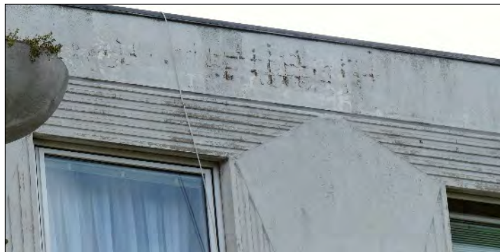
Manchen gemeindeeigenen Wohnobjekten sieht man die dringend notwendige Sanierung bereits von Weitem an.
